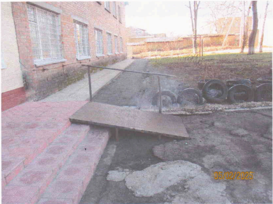
Мал. 3. Загальний вигляд пандуса для мало мобільних груп населення до нежитлової будівлі гуртожитку по вул. Щербаківського, 4-а
